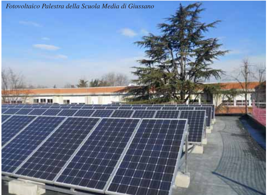
Fotovoltaico Palazzo municipale
