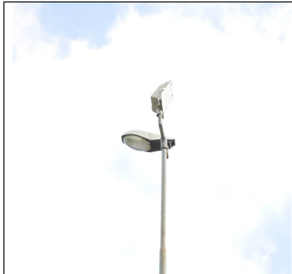
FIG. 4: esempio di armatura a montaggio Non conforme
