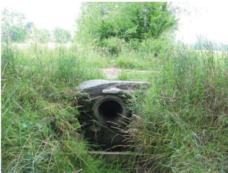
Fig. 6.25 Tubazione di collegamento sotto la strada poderale
