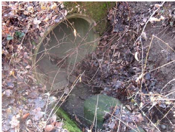
Fig. 6.68 La tubazione sotterranea a valle
