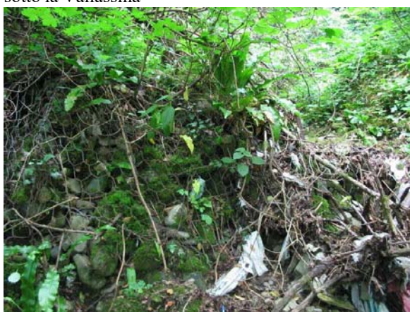
Fig. 6.65 Gabbioni parzialmente dissestati
