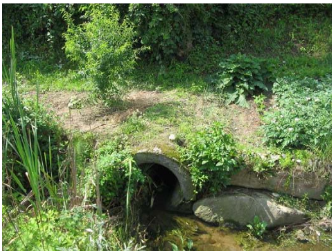
Fig. 6.31 La tubazione di ingresso del Canale di Arosio nel territorio di Giussano
