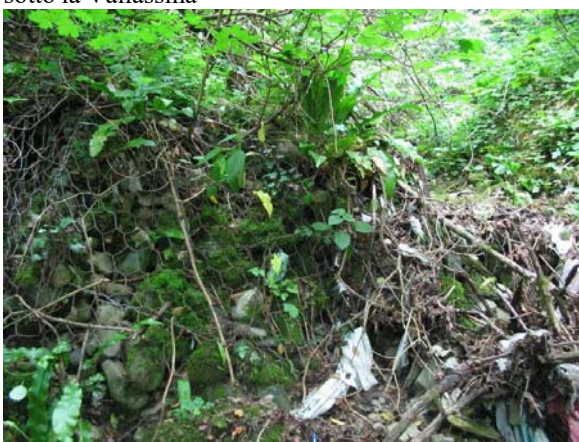
Fig. 6.65 Gabbioni parzialmente dissestati
