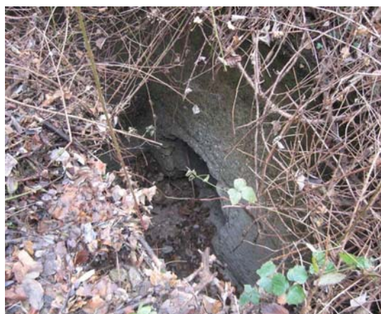
Fig. 6.66 Tombino e tubazione di captazione delle acque del torrente
