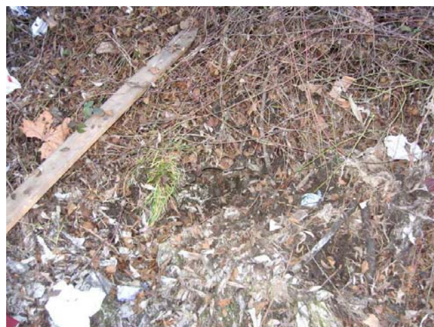
Fig. 6.70 E' appena visibile il bordo superiore della tubazione di scarico a Lambro, intasata da terra e rifiuti
