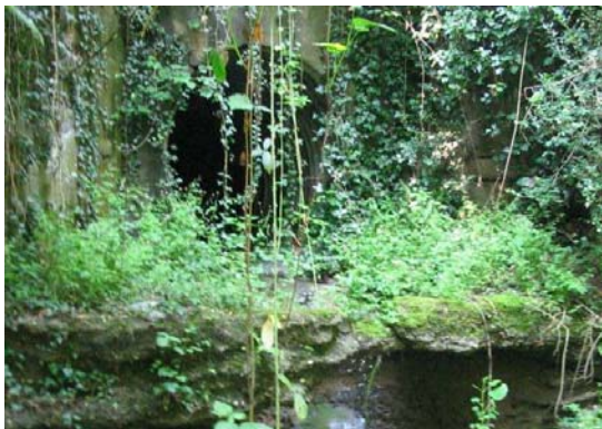
Fig. 6.63 Alveo in erosione allo sbocco della tubazione sotto la Vallassina
