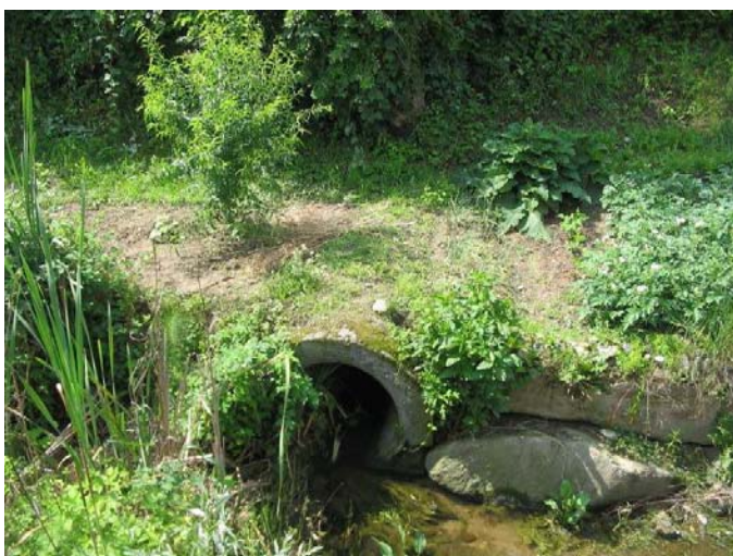
Fig. 6.31 La tubazione di ingresso del Canale di Arosio nel territorio di Giussano
