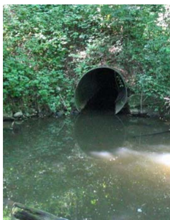
Fig. 6.57 La tubazione interrata del Riale all'uscita poco prima di sottopassare la Vallassina
